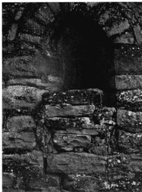
Una de les finestres del mur nord mig tapiada.
