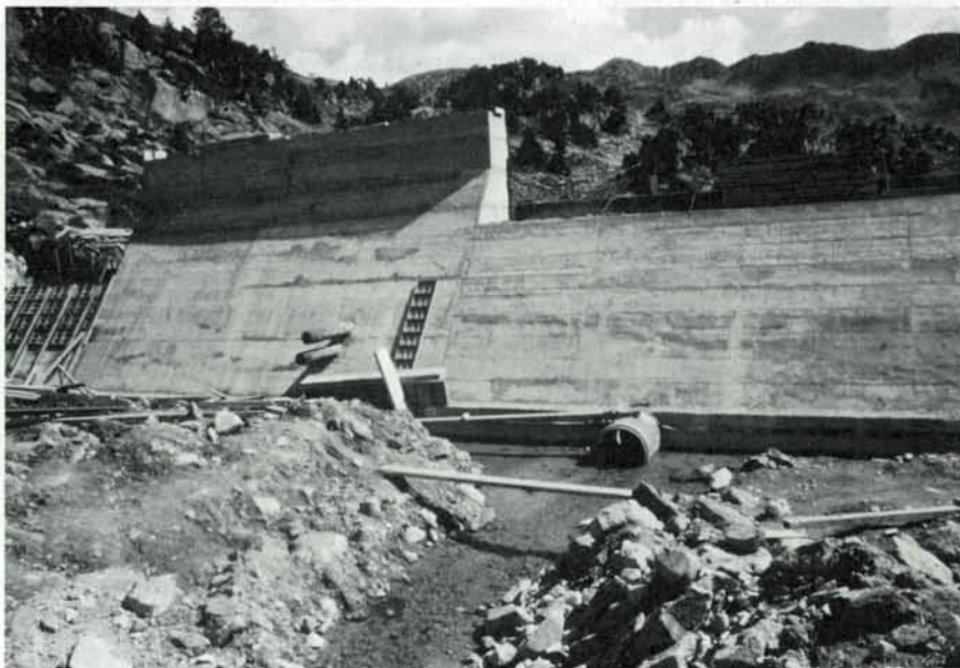
Una vista de la presa que l'estació d'esquí de Baqueira-Beret ha construït il·legalment a l'estany de Baciver, per al subministrament d'aigua d'una nova urbanització. Foto: Miquel Rafa.
